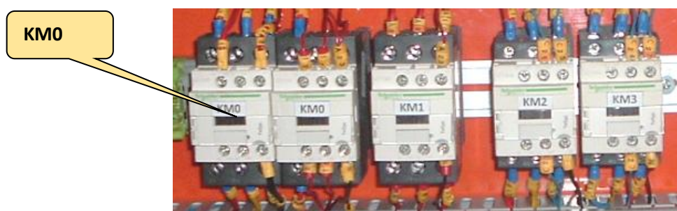
Hình 9.6: Kiểm tra contactor KM0 .
