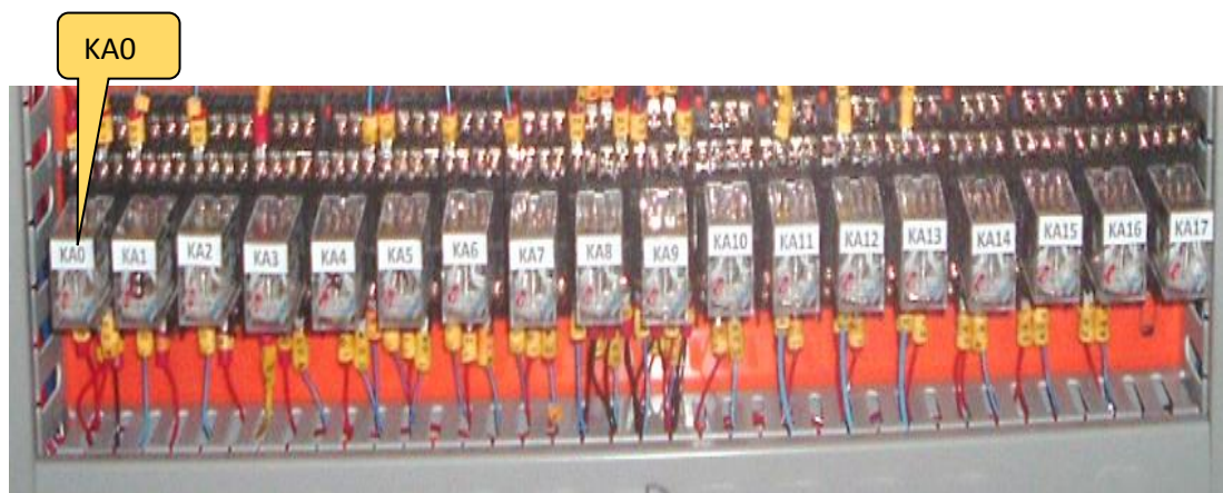
Hình 7.9: Kiểm tra rơ le trung gian KA0 .
